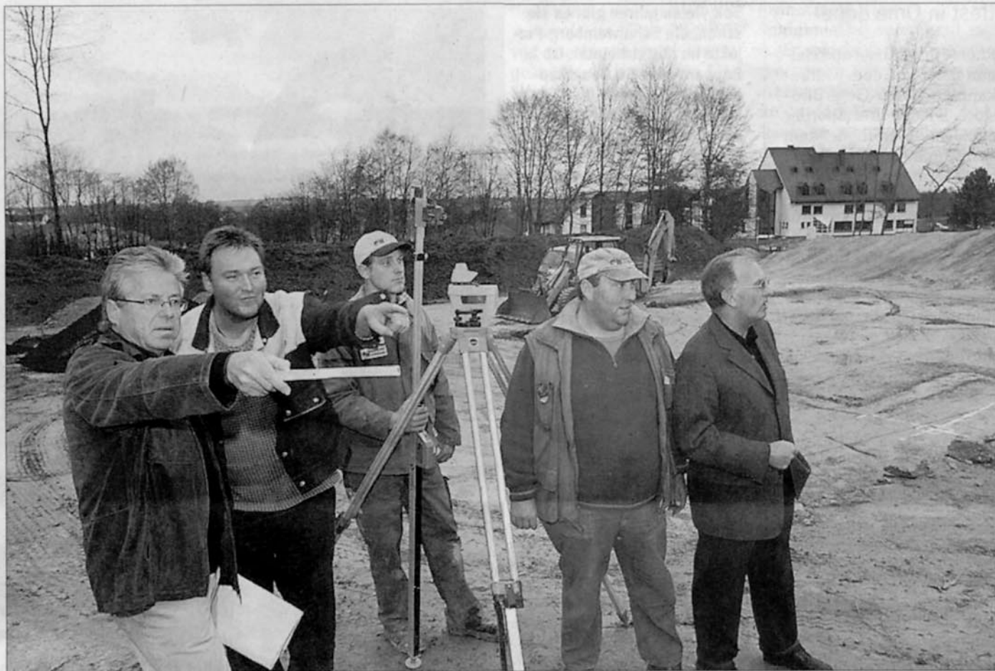
Architekt Bernd König bespricht mit den Bauarbeitern und Fritz Frey Details auf dem Wohnmobil-Platz. ■ Fotos: Werner Dupuis
